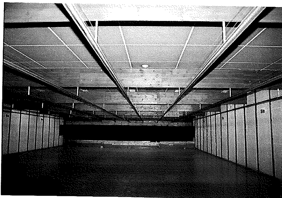
Fot. 4. Widok strefy strzelań strzelnicy. Podłoga betonowa wyłożona PCV, ściany wyłożone materiałem głuszącym, sufit podwieszany z płyt z zainstalowanymi przesłonami pionowymi. (wiszące). Kulochwyt główny – konstrukcja stalowa za płytą gumową.
