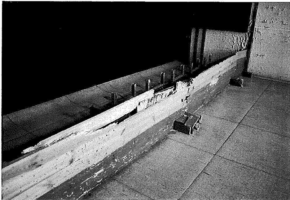
Fot. 8. Widok kulochwytu dolnego przed kulochwytem głównym. Konstrukcja zniszczona przez pociski, które trafiły w nią.
