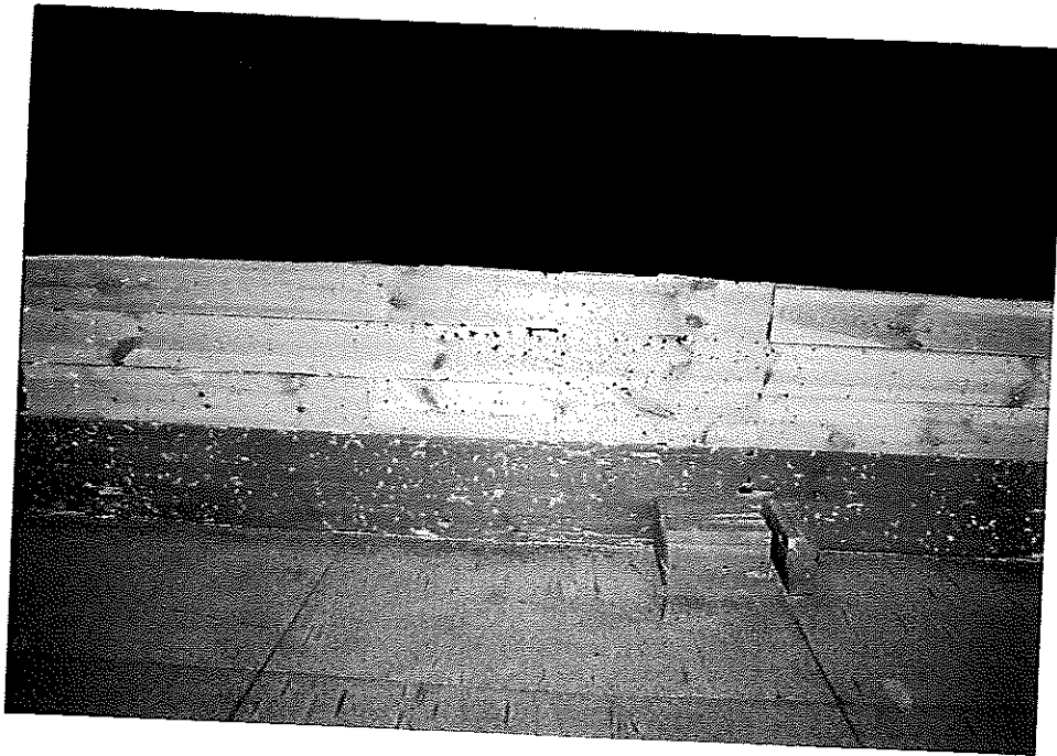
Fot. 9. Widok śladów trafień na płaszczyźnie czołowej kulochwyty dolnego.
